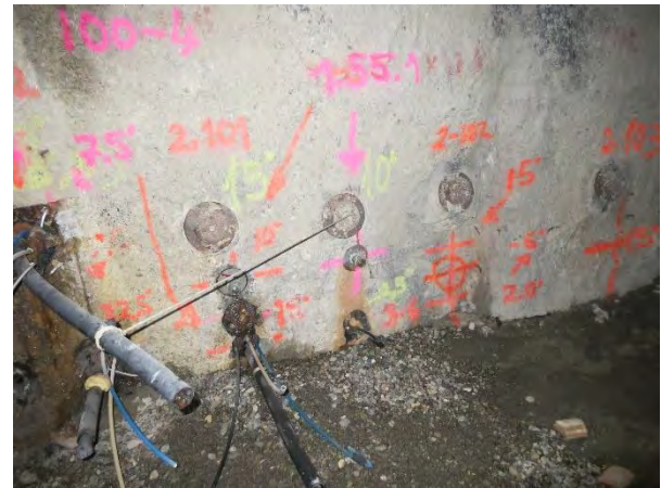
Abbildung 18: Beispiel der Ankerumplanung im Bereich des Luftschutzbunkers (Ansicht auf Schlitzwand aus Bestand heraus).
