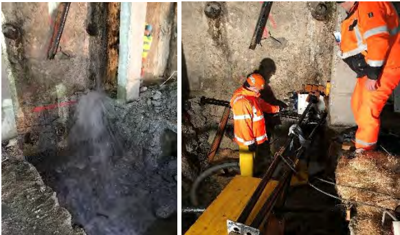
Abbildung 26: Angetroffene Leckage einer Fehlstelle der Schlitzwand infolge der Rückbauarbeiten und Abdichtung der Leckage mittels Kunstharz.
